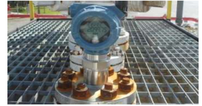
Control de nivel 85%
